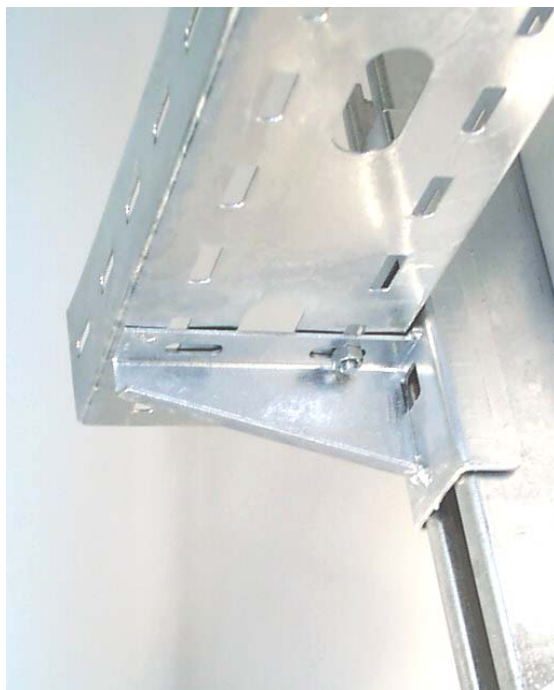
Fig. 6: Kabelbakke ophængt på konsol type KBS. Konsollen monteres på vægskinne eller loftpendel. På hårde overflader (beton) kan konsollen også anvendes direkte på væg. På porøse vægge anvendes bagplade, eller konsoltype KBU (se nedenfor) som er beregnet til direkte vægmontage.
