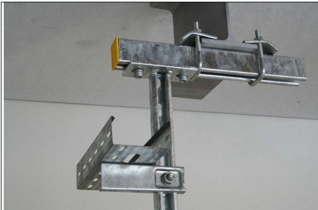
Fig.10: Kabelbakke monteret på pendel med KBL-konsol, LLO-pendel på vægskinne 50V. Vægskinnen er fastgjort til drager med SSB-beslag.
