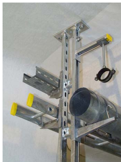
Fig. 3. El-VVS, og ventilation monteret på samme pendel.
