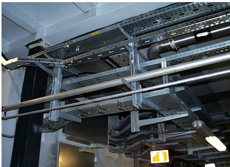
Kølerør monteret på konsoller (KBS) på pendler (DLO). (Haldor Topsøe)
