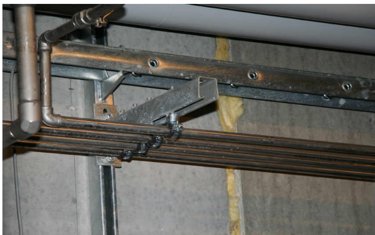
Trykluftrør monteret på pendel(ELO) under kabelstige(KS) på vægskinne (50V). (UnoMedical)
