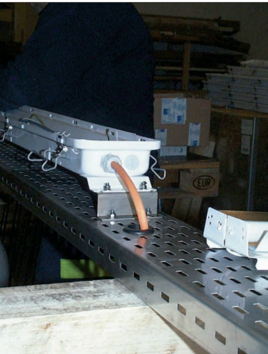
Armatør færdigmonteret på kabelbakke. Bemærk den specielle perforering til kablet.
