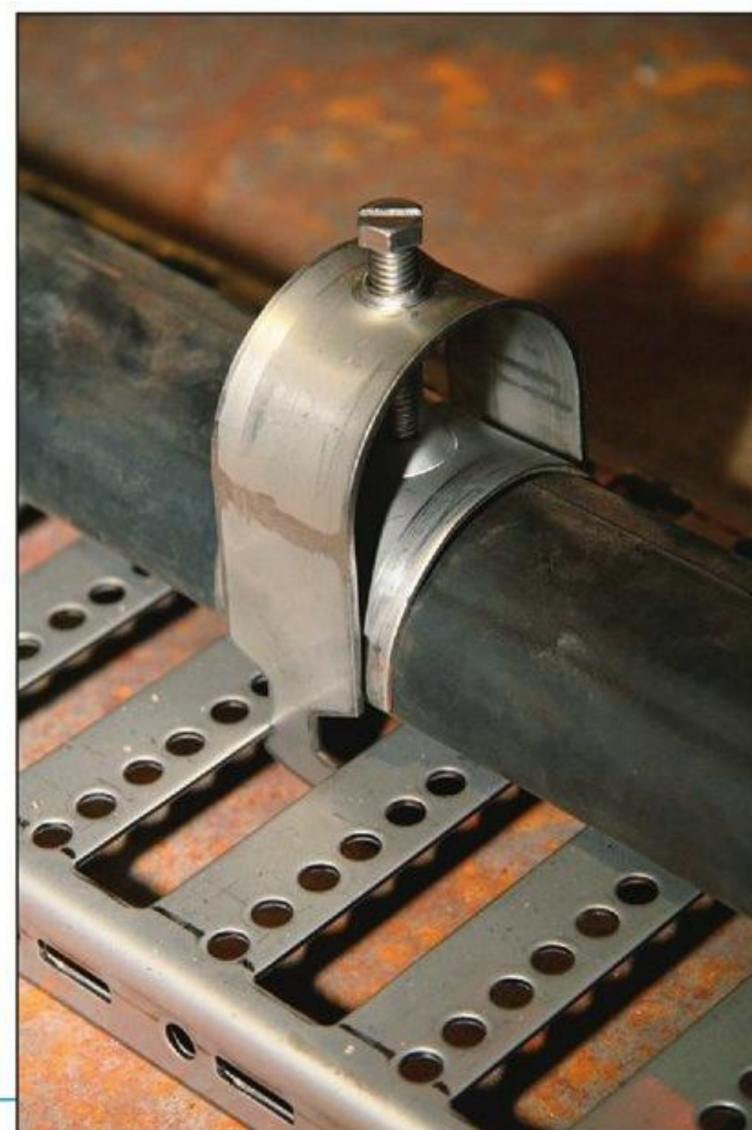
Montage på standard kabelplade, hvor kabel er fastgjort med syrefast rustfri H-bøjle.
