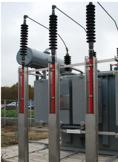
KA100SS monteret ved trafo. (SEAS NVE 2007)
