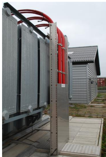
KA900SS monteret ved trafo. (SEAS NVE 2007)
