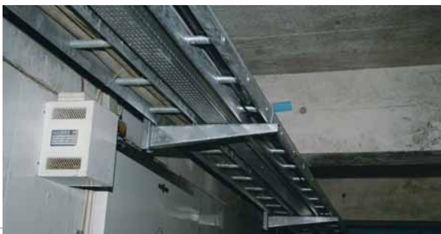
Eksempel på ombygning hvor nyt hovedkabel er lagt ind på KS100 mm kabelstige (til højre i billedet). Den oprindelige installation er bibeholdt, men nye konsoller er monteret, så ny og gammel installation deler support.
