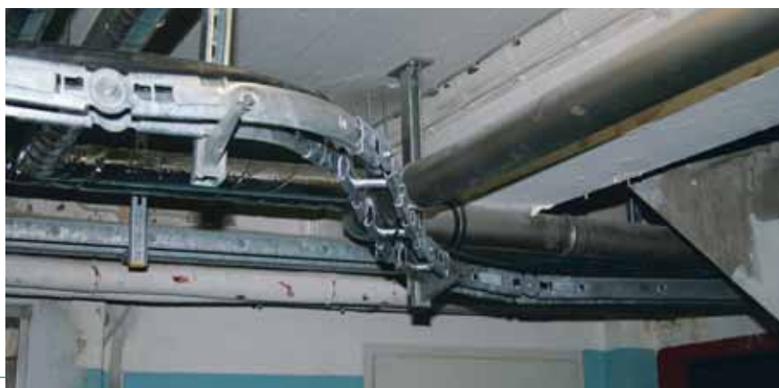
Eksempel hvor nyt hovedkabel er »strikket« ind i ny og oprindelig installation af el, VVS og ventilation via KS100 mm kabelstige. Der er simpelthen ikke plads til en kabelstige af bredere dimension.
